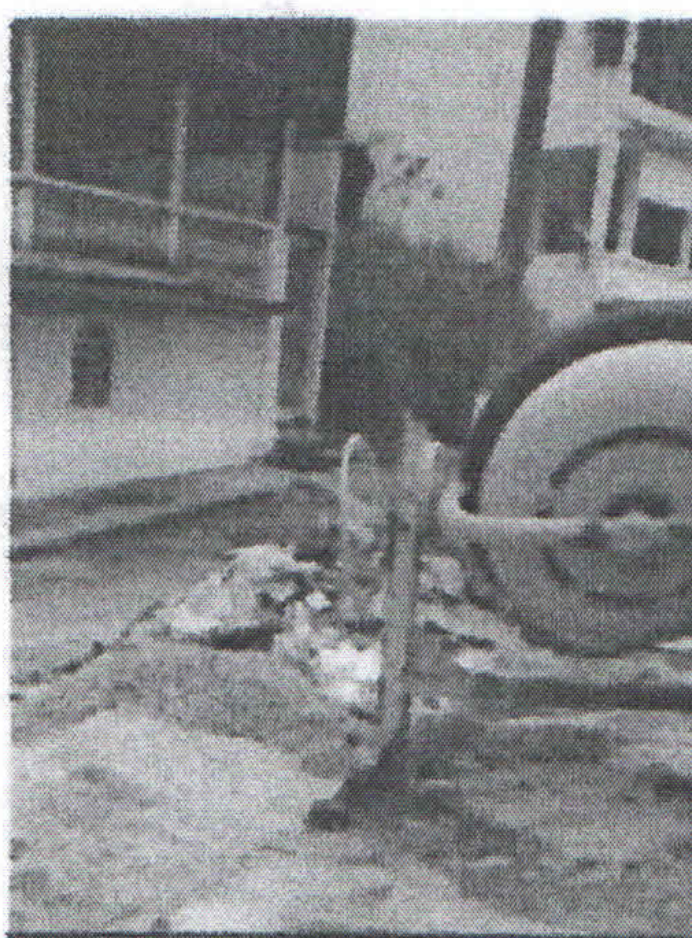
Materiais de construção civil acarretando carga ao solo comprometido.
