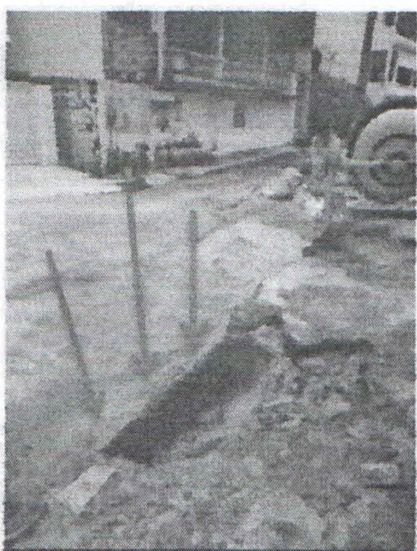
Escoamento das águas na fenda, percolação ao sopé do muro.
