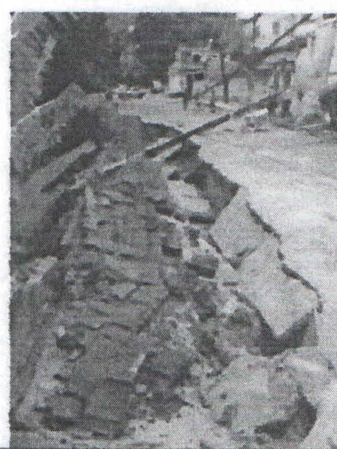
Imagem lateral após o desabamento, calçada em estado de alerta de novo desabamento.
