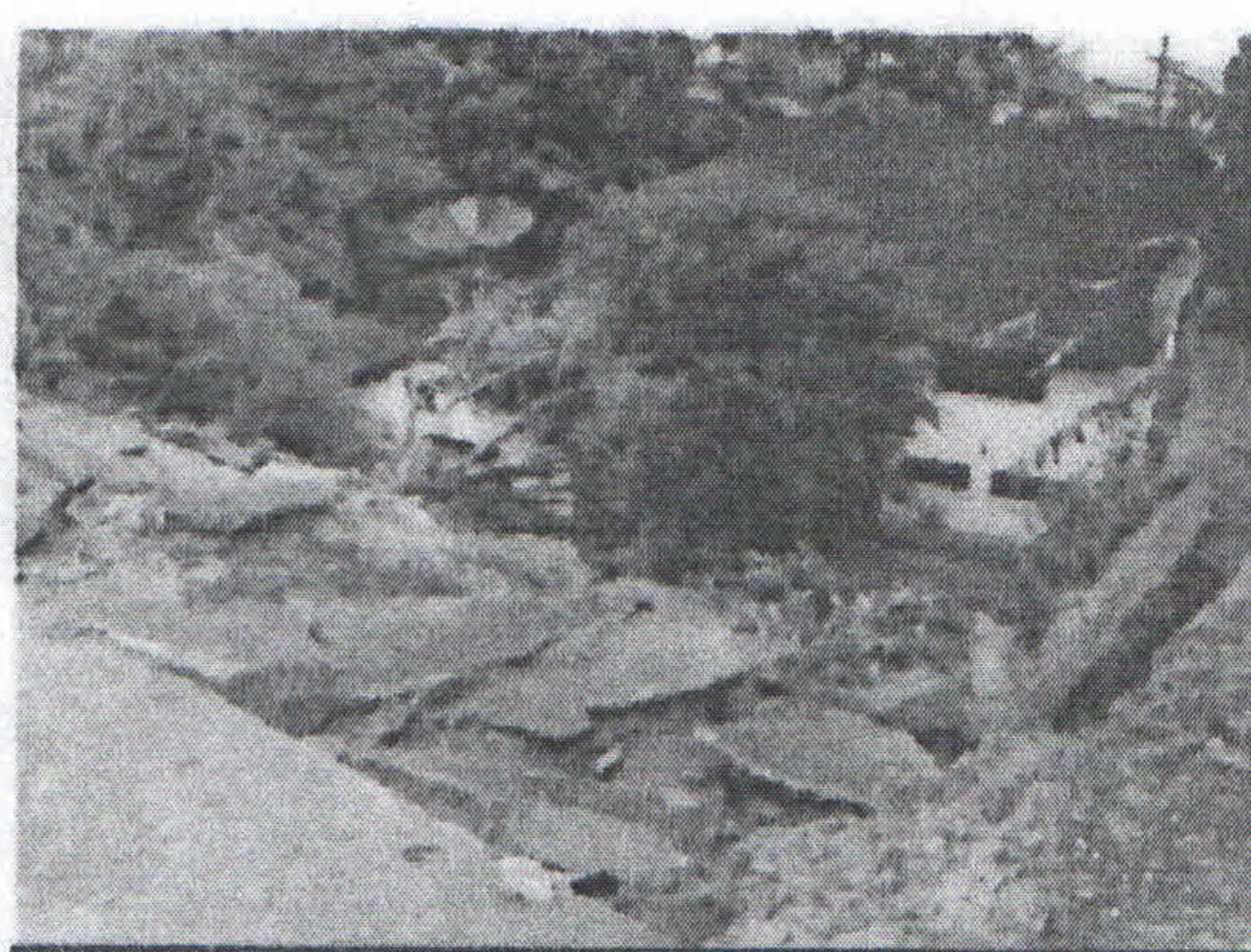
Imóvel interditado, vulnerabilidade iusante ao desabamento.
