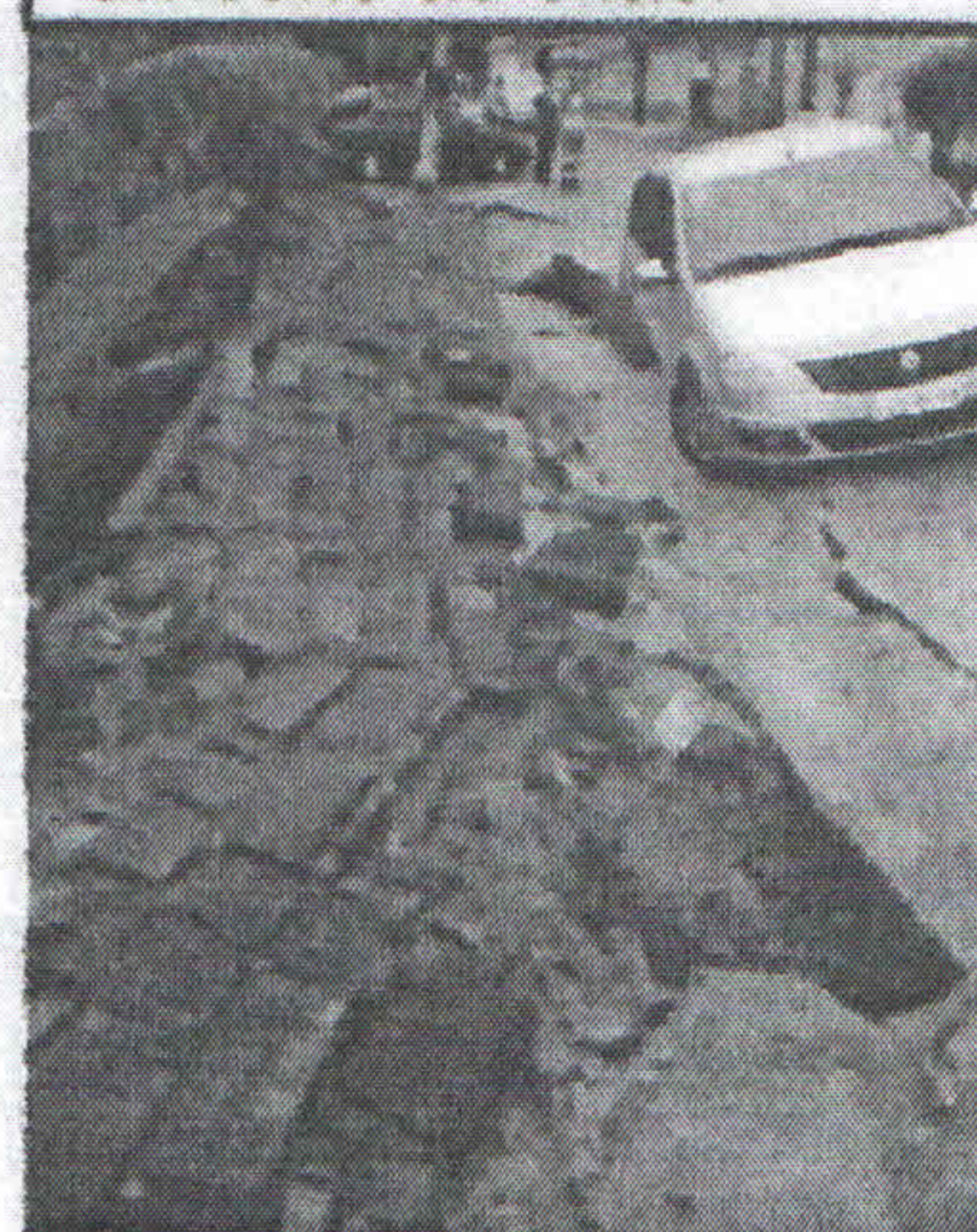
Imagem antes do desabamento, muro divisório ao chão.
