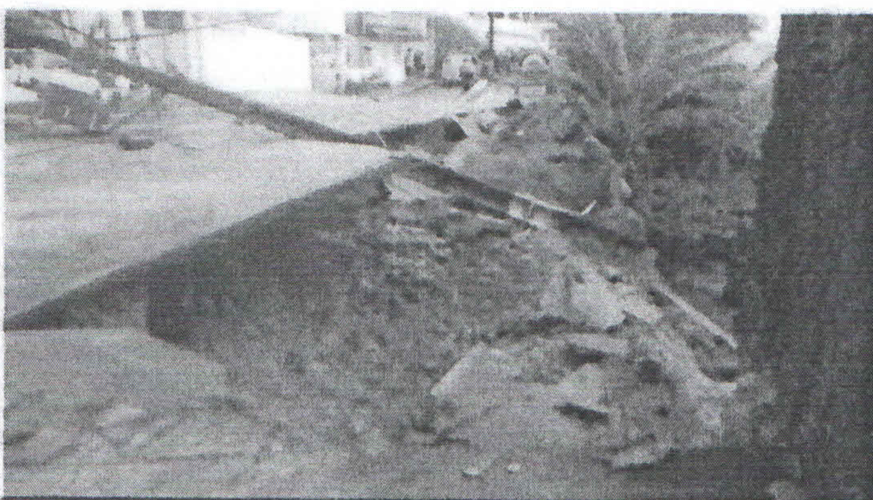
Imagem lateral após o desabamento, queda do poste.
